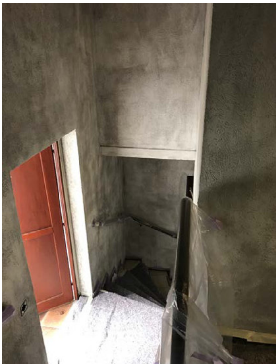
Der Mensakeller ist stark in Mitleidenschaft gezogen worden und muss fast komplett saniert werden
