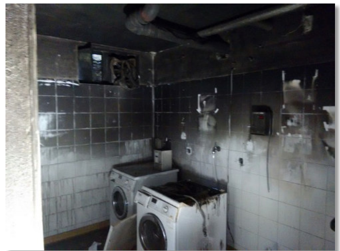
Der Wäschekeller nach dem Brand
